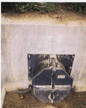
HADE Zaporna loputa na protipoplavnem nasipu
