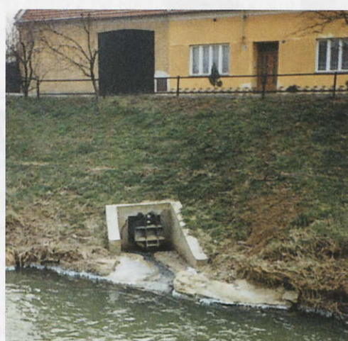
HADE Zaporna loputa na kanalizaciji ▶
