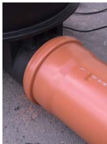
Pravilno izveden PVC izstopni priključek
